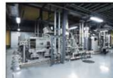
コージェネレーション設備
