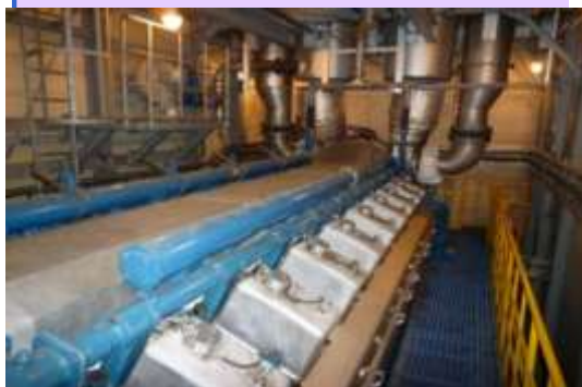
ガスエンジン コージェネ(6MW) (日立造船)
