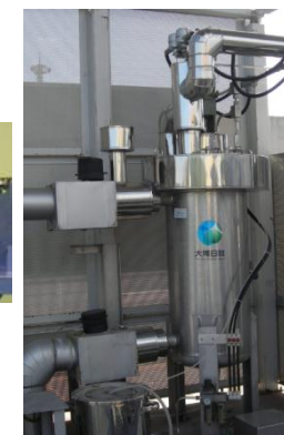
プレカール設備
