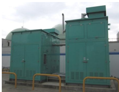
水素製造装置
